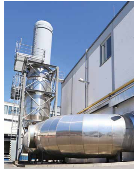
Klares Statement zum Energiesparen: Das eigene »Kraftwerk« hat mit ca. 80% einen sehr hohen Wirkungsgrad.
